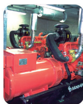
1200KVA's de geração própria
